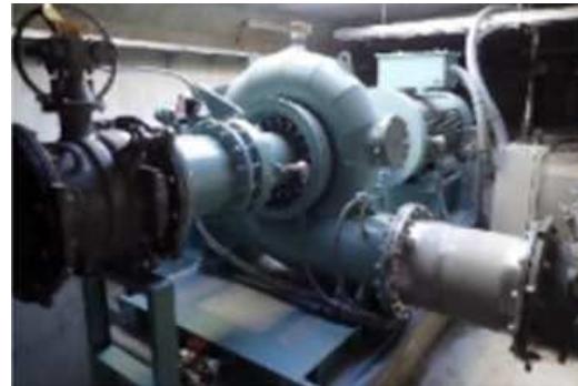
浄水場小水力発電
