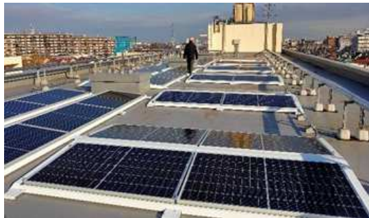
災害時の非常用電源に
