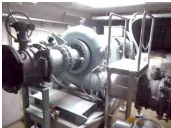
小水力発電設備
